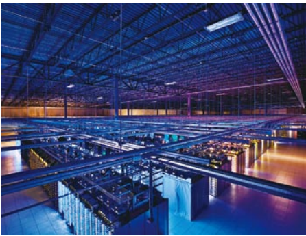
まるでSF映画に出てきそうな、アメリカ・アイオワ州にあるグーグル・データ・センター（http://www.google.com/about/datacenters/gallery/#/tech/1）
